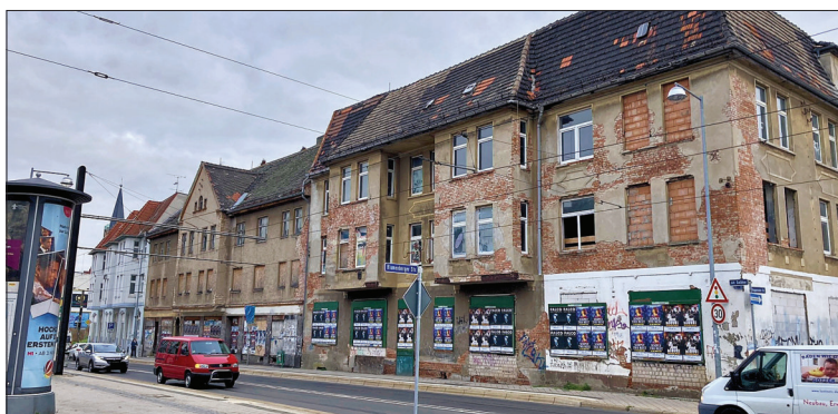
Der schlechte Zustand des Häuserzuges sorgt dafür, dass eine MVB-Haltestelle im Salbker Engpass aus Sicherheitsgründen verlegt werden muss.
